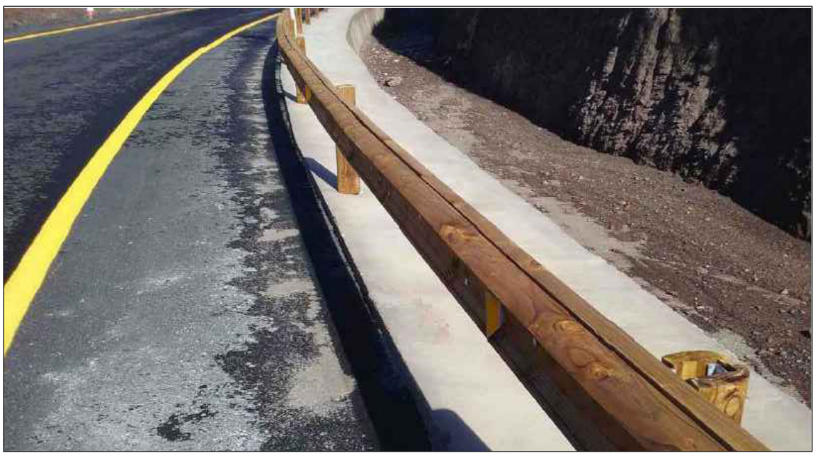
DEFENSAS REVESTIDAS S/E
